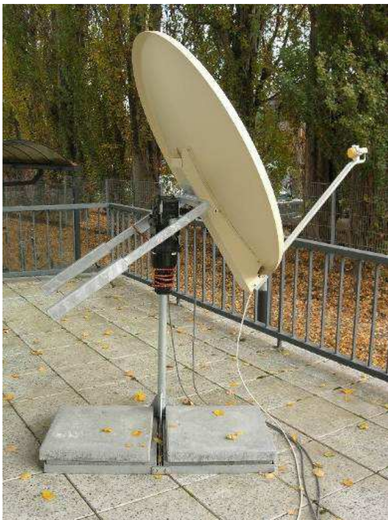
Fot. 2.16. Inny przykład konstrukcji anteny radioteleskopu. Podstawa metalowego stojaka jest obciążona betonowymi płytami chodnikowymi.
